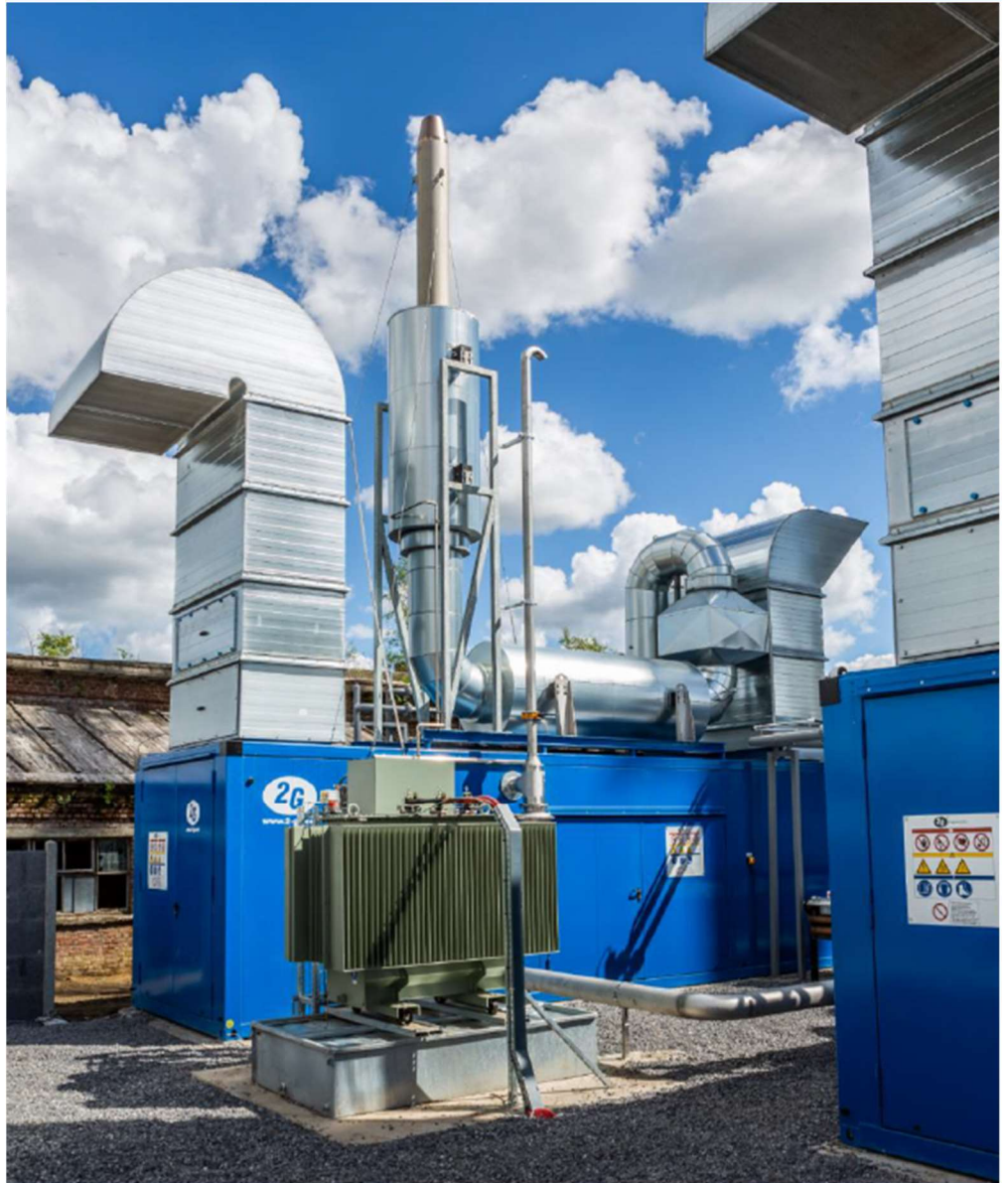
La Française de l'Energie – Standardised cogeneration 1.5 MW unit
