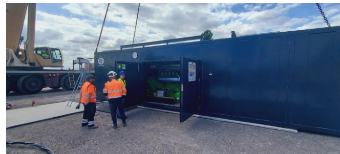
Finalisation des travaux pour les deux unités à Rouvignies, Nord de la France
