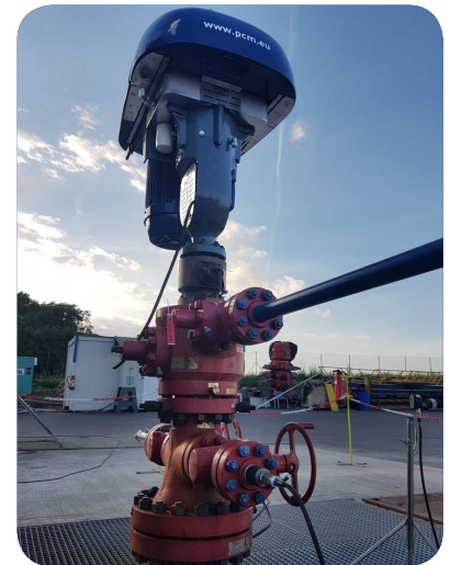
Tête de puits Lachambre CBR-1
